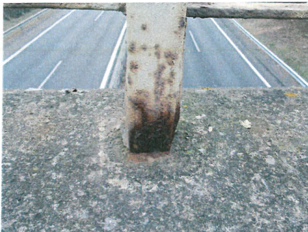
Obr. 43: Korozí zábradelního sloupku zevnitř průřezu.
