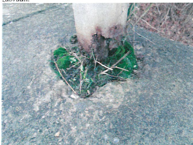
Obr. 35: Havarijný stav sloupků zábradlí.
