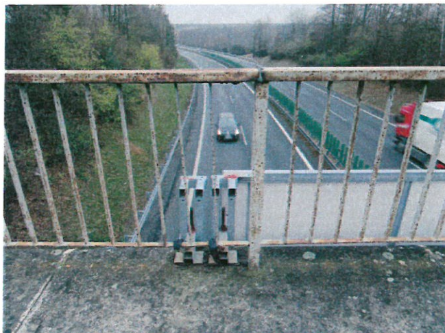
Obr. 42: Koróze madla zábradlí.
