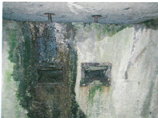
Obr. 9: Silné zatékání na líc opěry.
