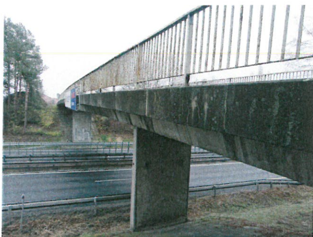
Obr. 31: Síťované trhliny v římsě.
