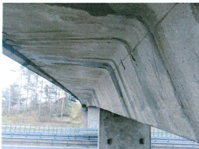
Obr. 27: Krycí vrstva výztuže oddělená od podkladu.
