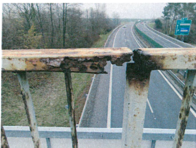
Obr. 39: Koróze průřezu madla zábradlí.
