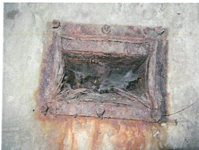
Obr. 20: Trhlina v pracovní spáře opěry.
