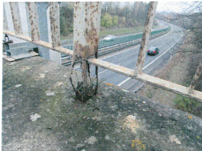
Obr. 38: Havarijný stav sloupků zábradlí.
