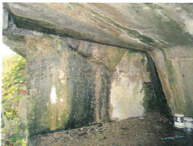
Obr. 23: Trhlina v pracovní spáře opěry.
