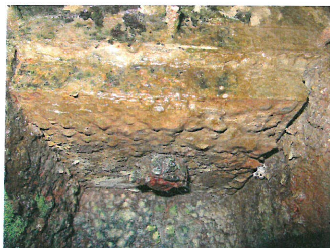
Obr. 10: Koroze dolní ocelové desky tahového ložiska.
