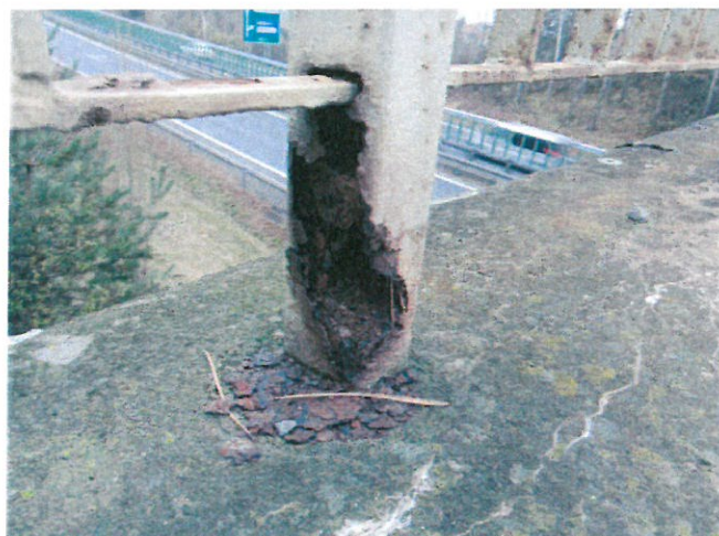
Obr. 36: Havarijný stav sloupků zábradlí.
