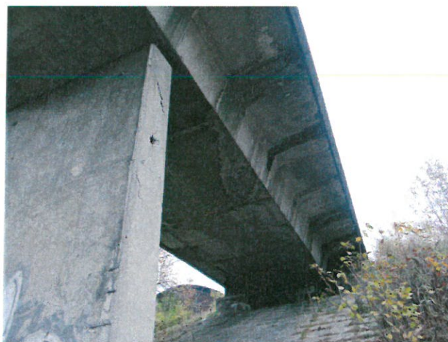
Obr. 14: Korozí výztuže západního stěnového pilíře.
