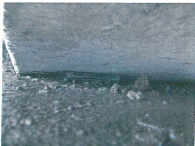
Obr. 3: Krajiní ložisko na západní opěře.
