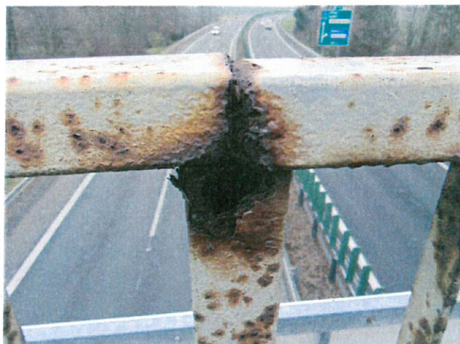
Obr. 40: Koróze sloupku ve styku s madlem.
