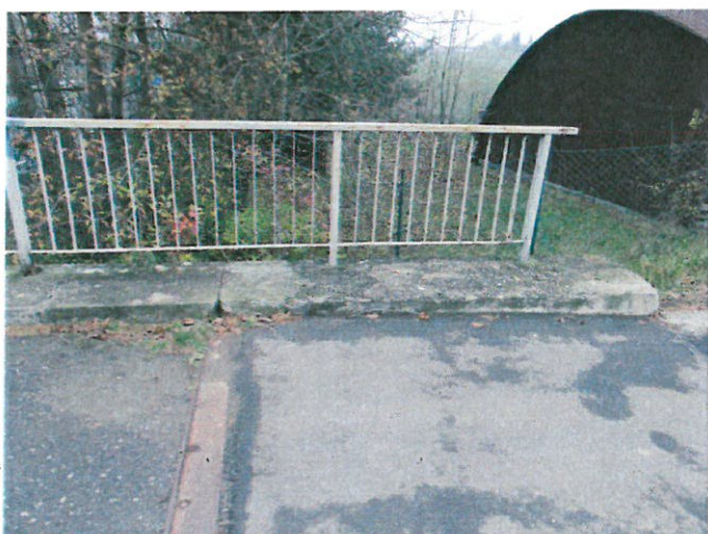
Obr. 45: Detail MZ, chybí dilatační styky zábradlí.
