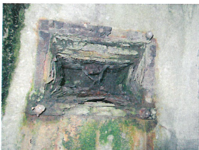
Obr. 11: Koroze skříňě dolní desky tahového ložiska.
