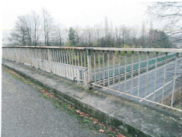
Obr. 37: Havarijný stav sloupků zábradlí.
