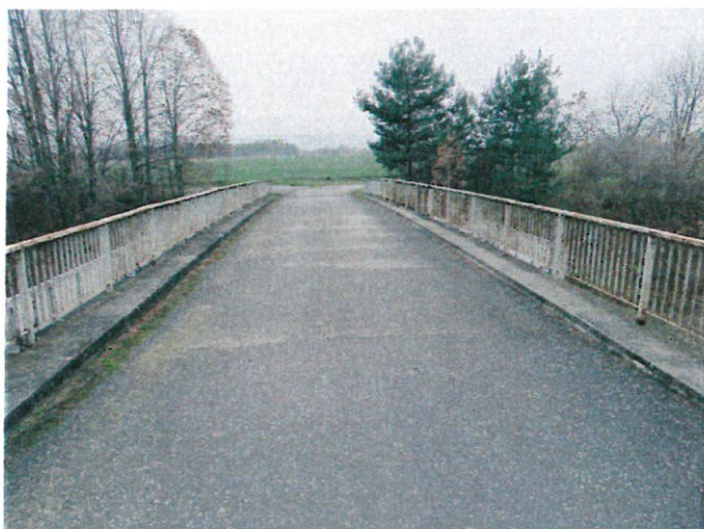
Obr. 41: Příčné trhliny ve vozovce.
