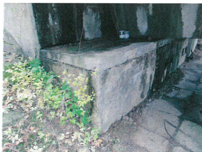
Obr. 24: Trhlina v úložném prahu.
