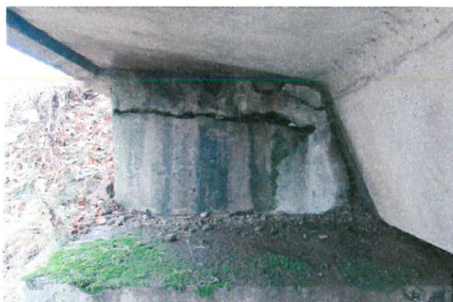
Obr. 2: Ležatá trhlina v pracovní spáře v závěrné zídce.
