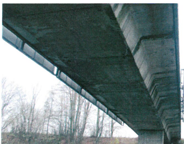
Obr. 29: Zatékání na podhled a konzoly NK.
