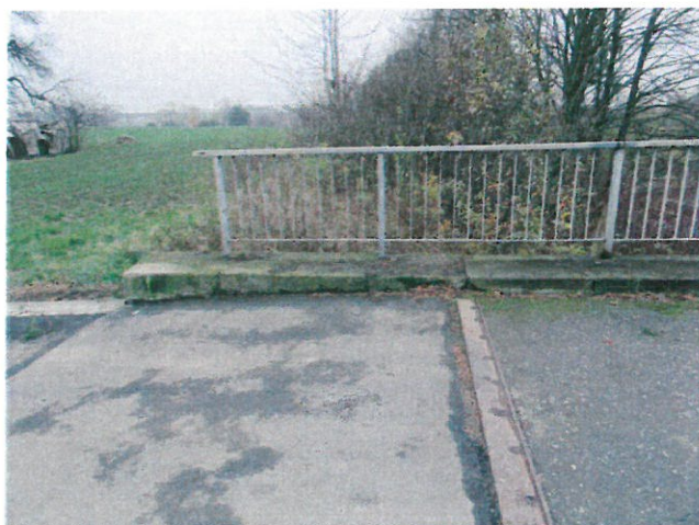
Obr. 47: Nad dilatačním závěrem chybí dilatační styk zábradlí.
