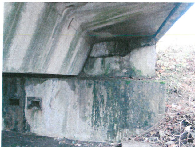
Obr. 7: Trhlina v pracovní spáře západní opěry.
