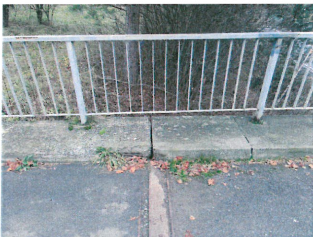
Obr. 33: Detail MZ nad západní opěrou, chybí dilatační styk zábradlí.
