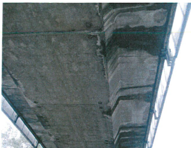
Obr. 25: Silné zatékání spárami v římsách na povrch NK.
