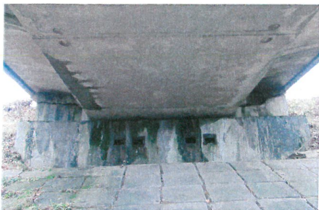
Obr. 1: Pohled na západní opěru, mohutné zatékání.
