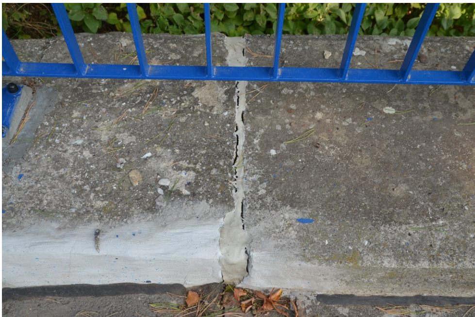
Obr.E62-32 Mostní závěr v pravostranné římsy nad 4. podpěrou, polní opěrou. Pohled zleva doprava a dolů,
