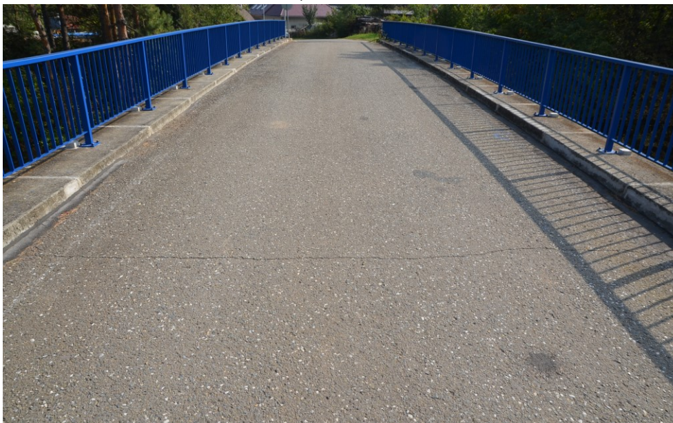
Obr.E62-38 Vozovka, římasy a zábradlí na první polovině mostu. Pohled přibližně z poloviny rozpětí, proti směru staničení k Žešovu,
