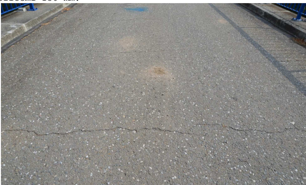
Obr.E62-40 Detaily příčných trhlin v krytu vozovky ve třetí čtvrtině délky mostu. Pohled proti směru staničení k Žešovu.
