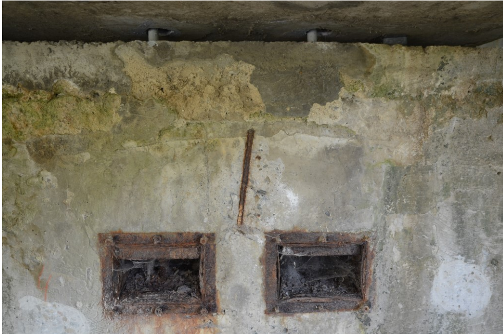
Obr.E62-33 Detail kotvení začátku NK do 1. podpěry, žešovské opěry. Dvojice kotvicích tyčí (2., 1.) pod levou komorou dvojkomorového trámu. Pohled proti směru staničení k Žešovu,
