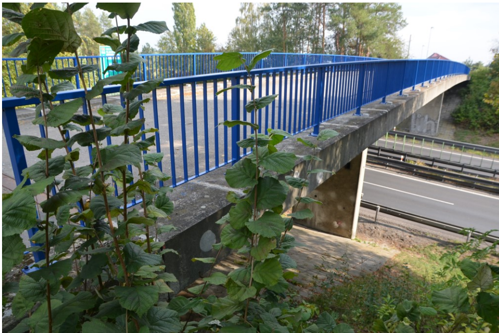
Obr.E62-23 Levá, vyškovská fasáda (římsové a ZBZ) mostu. Pohled zleva doprava a proti směru staničení od pole k Žešovu,
