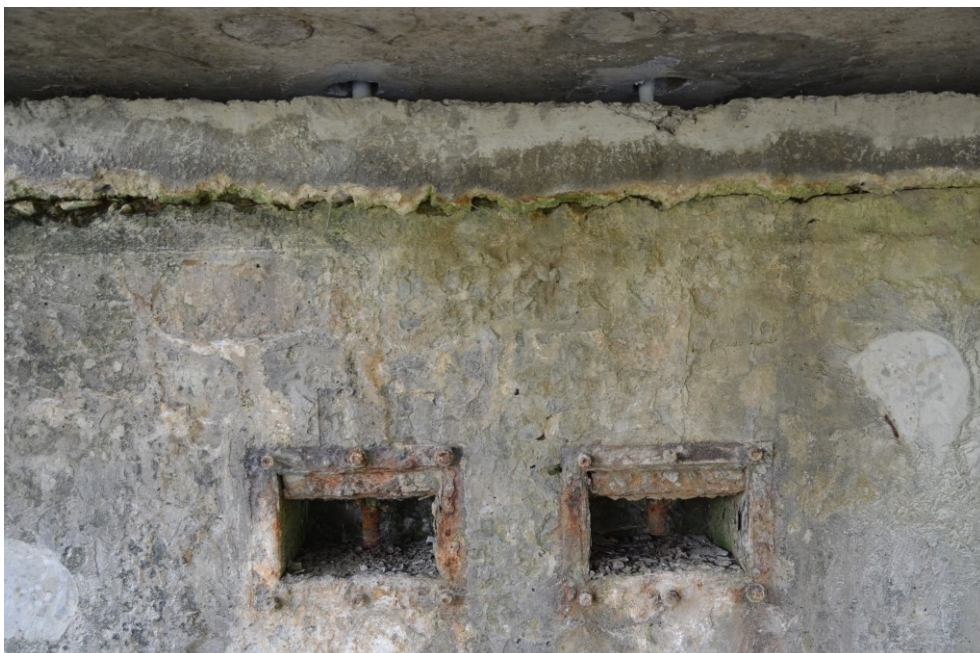
Obr.E62-34 Detail kotvení začátku NK do 1. podpěry, žešovské opěry. Dvojice kotvicích tyčí (4., 3.) pod pravou komorou dvojkomorového trámu. Pohled proti směru staničení k Žešovu,
