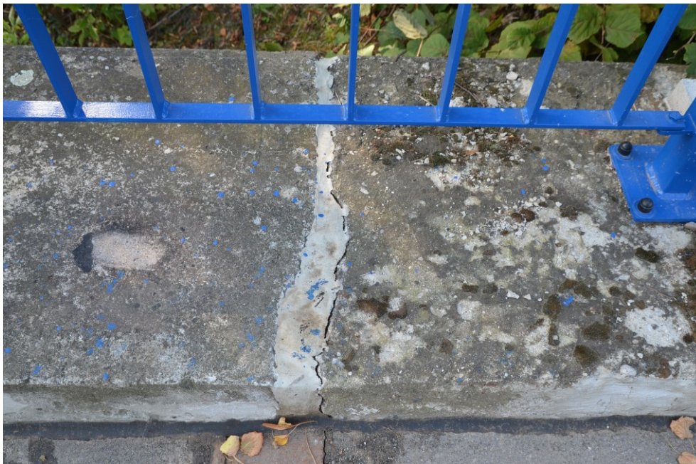
Obr.E62-29 Mostní závěr v levostranné římse nad 4. podpěrou, polní opěrou. Pohled zprava doleva a dolů,
